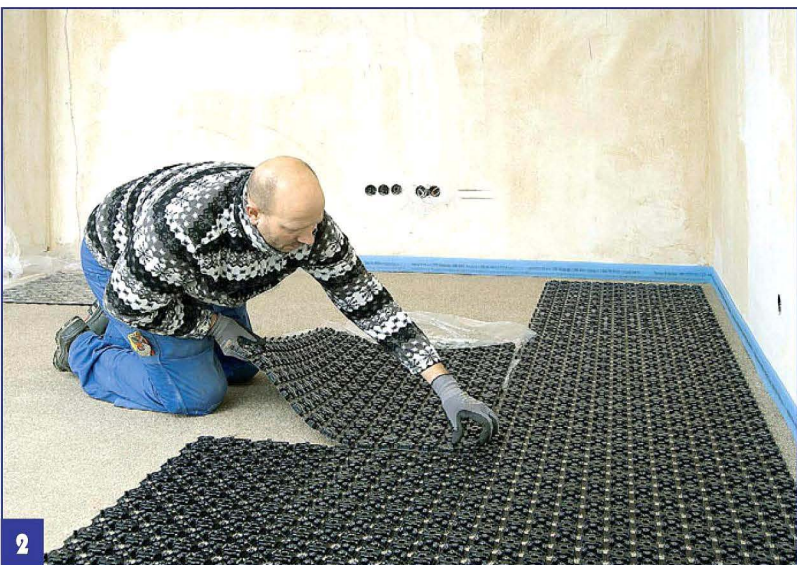
2 После укладки утеплителя и мультифольги приступают к монтажу панелей для укладки труб.
