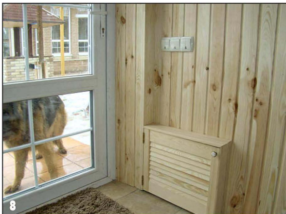
8 Шкафчик ввода коммуникаций.
